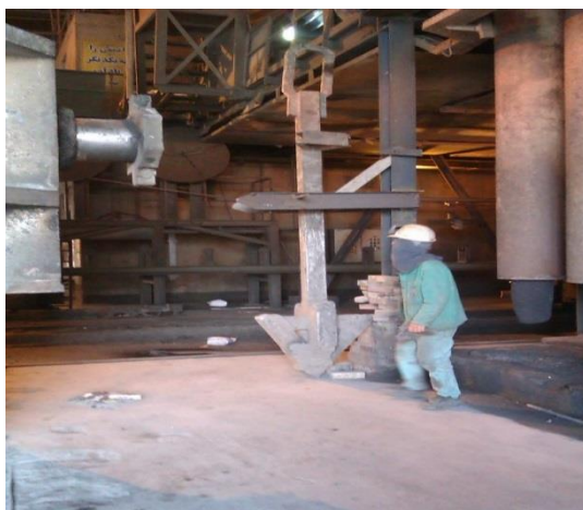
شکل ۳: ایستگاه کاری اسلایدگیت- بعد از مداخله
